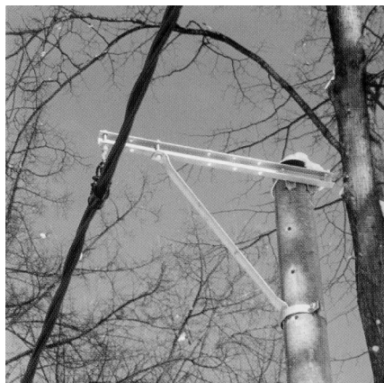
Линия СИП до 42 кВ пересекает лес
